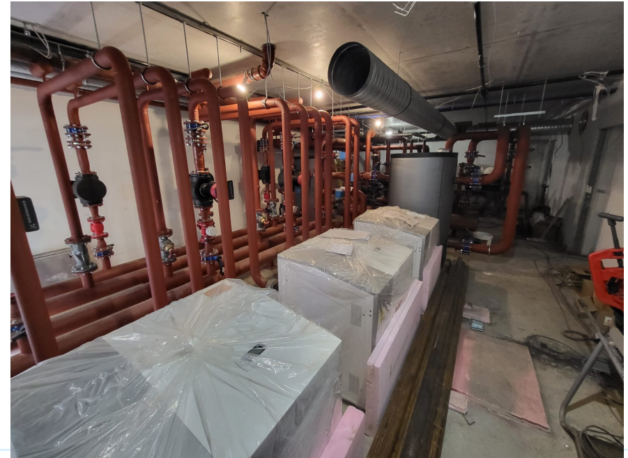
DT tlo-voda 3x100 kW
