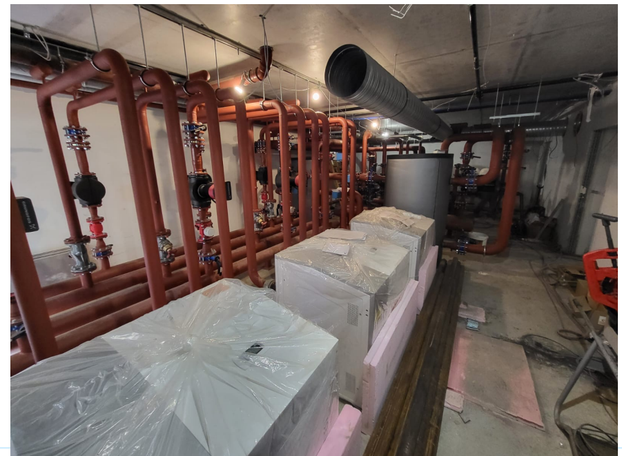
DT tlo-voda 3x100 kW
